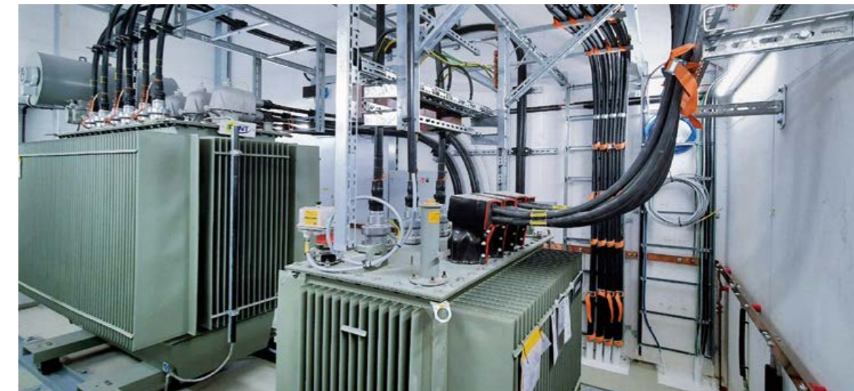
Elektroinstallation, Kraftwerk Töging, Deutschland
