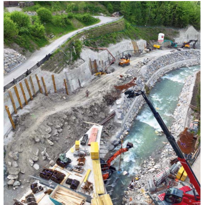
Wasserkraftwerk, Wagrain, Österreich
